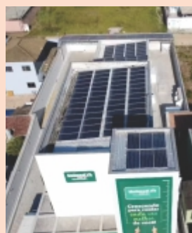
Placas solares instaladas no nova sede administrativa
